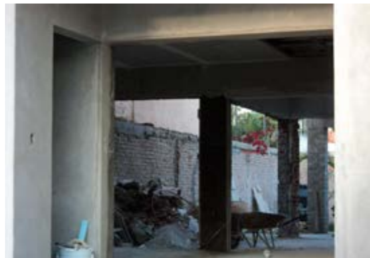
Fig. 8 y 9. Estado actual vivienda Peña y Peña, Morelia, Michoacán, 2012. Fotografías: Gloria Belén Figueroa.
